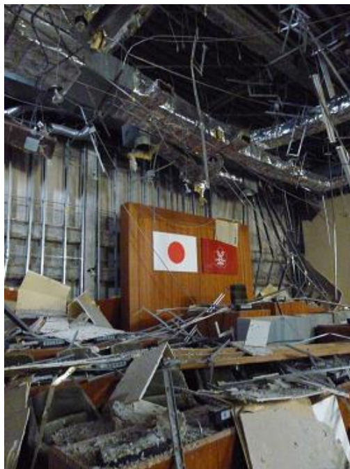
天井の崩落した議場
